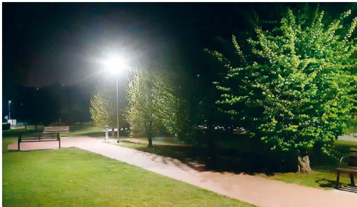
Il nuovo impianto di illuminazione pubblica a San Pietro di Lavagno
